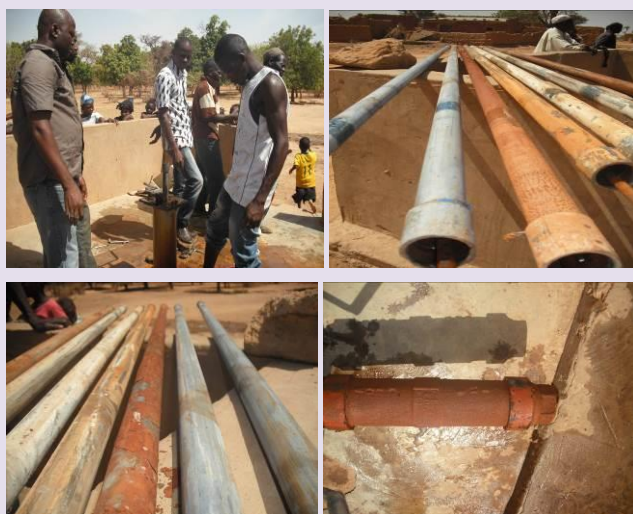
Ci-dessous, l'opération de démontage des colonnes galvanisées de la pompe INDIA installée à la suite de la réhabilitation du forage et qui présente de la teinture brune-rouge
